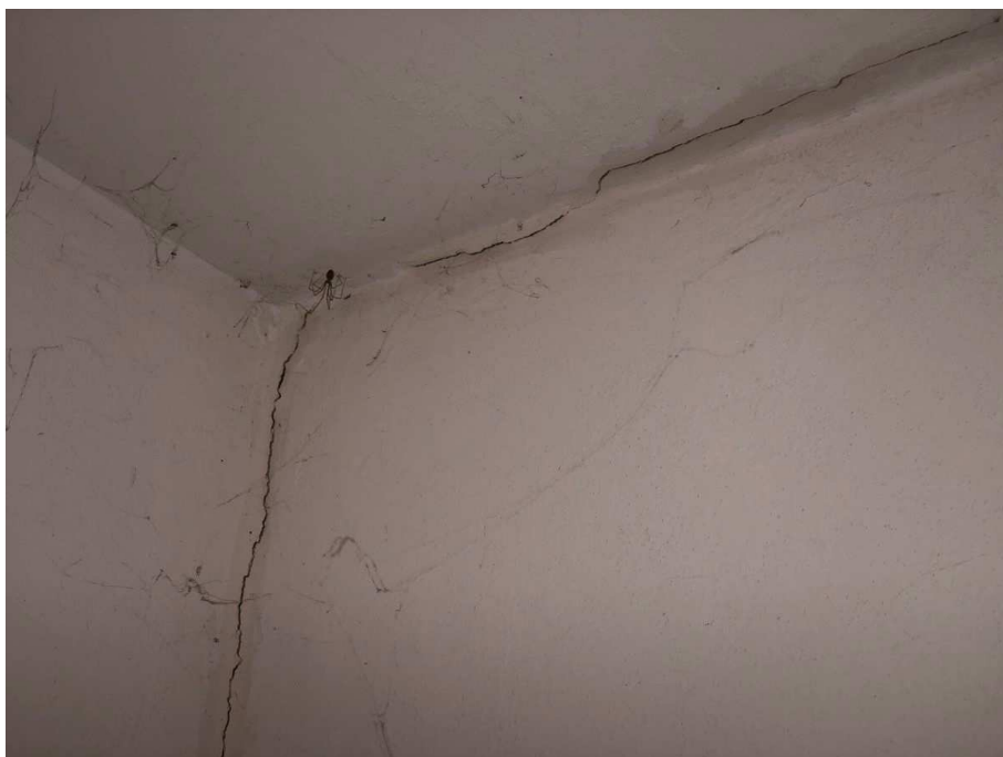
Obrázek 48: Trhlina mezi obvodovou stěnou (vlevo), vnitřní příčkou a stropem
