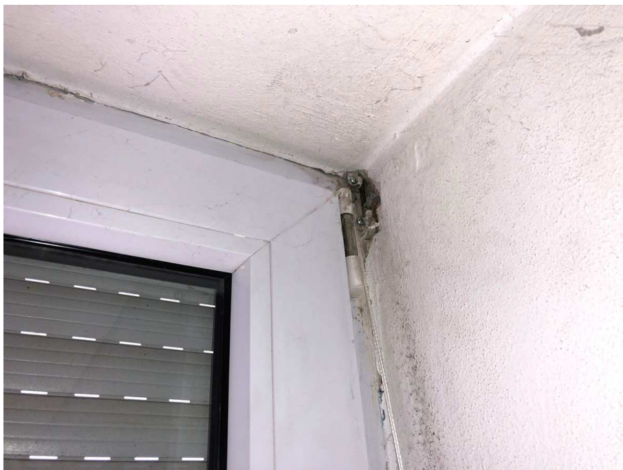
Obrázek 75: Roh místnosti u okna, výrazné stopy kondenzace a plísně
