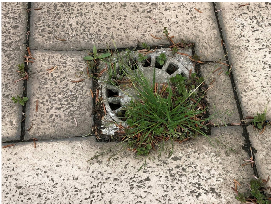
Obrázek 16: Vpust na terase, pravděpodobně nefunkční
