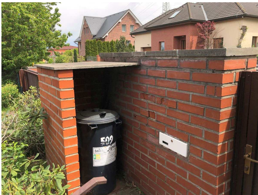
Obrázek 28: Přístřešek na popelnice, oprýskané lícové cihly
