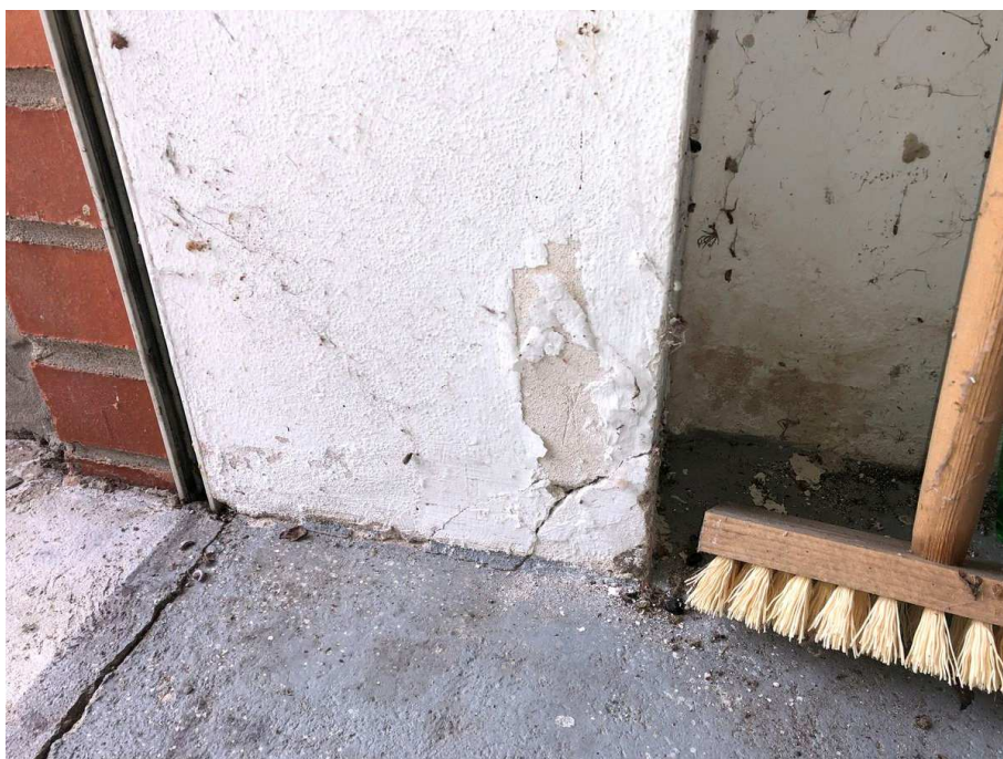
Obrázek 41: Znamky vlhkosti u vrat do garáže, pravděpodobně kvůli vnějšímu záhonu
