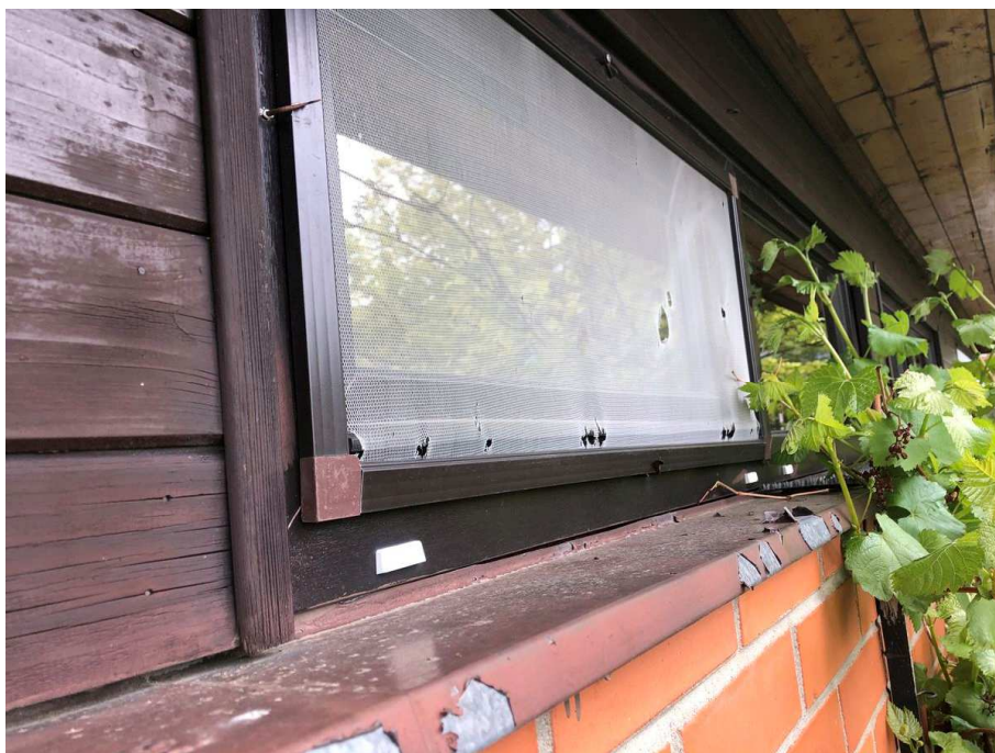
Obrázek 22: Narušený lak na oplechování, rozpadlá síť proti hmyzu
