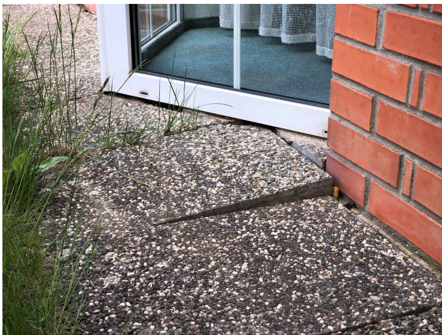
Obrázek 9: Dolní napojení okna na okapový chodník, výrazné poklesy, pravděpodobně netěsné
