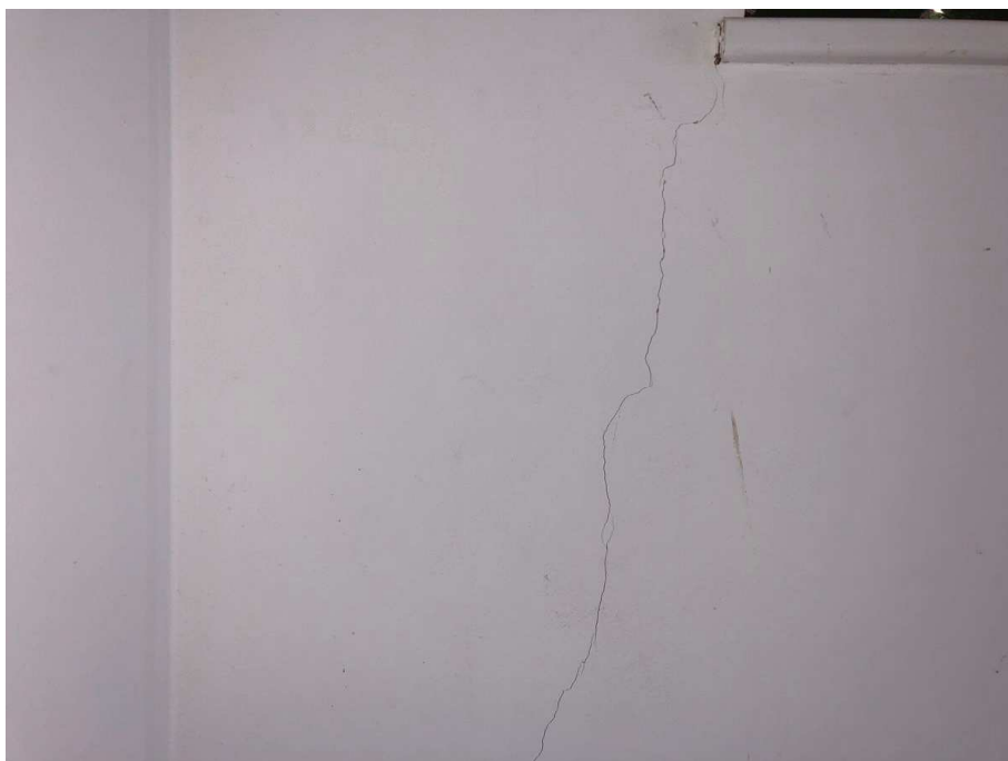
Obrázek 87: Trhlina u okna do ulice
