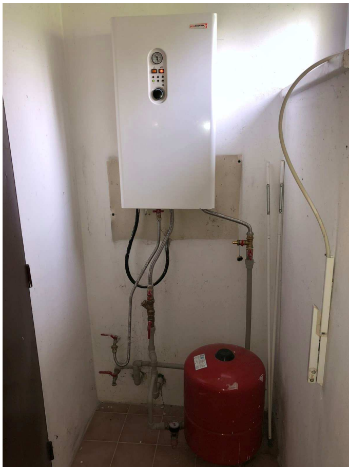
Obrázek 44: Elektrokotel Protherm, zdroj tepla pro RD
