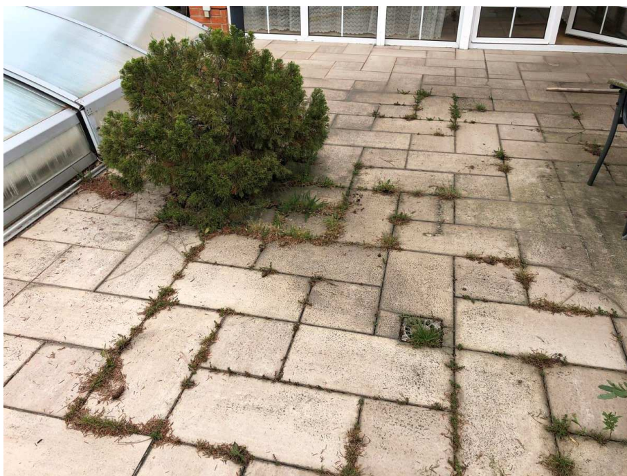
Obrázek 15: Dlažba terasy, výrazně prorostlá rostlinami
