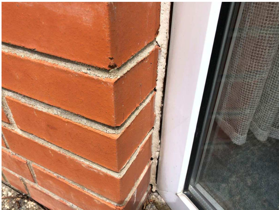
Obrázek 7: Boční spára okna, výrazná trhлина v silikonovém tmelu, vadné řešení!
