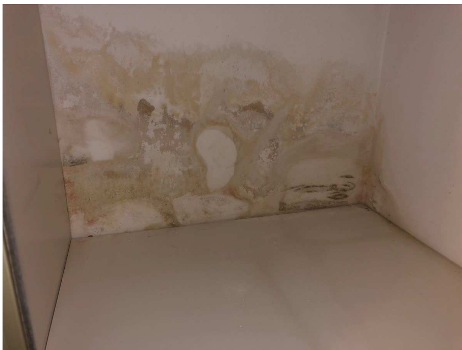
Obrázek 93: Výrazné stopy vlhkosti v místě vestav. skříně
