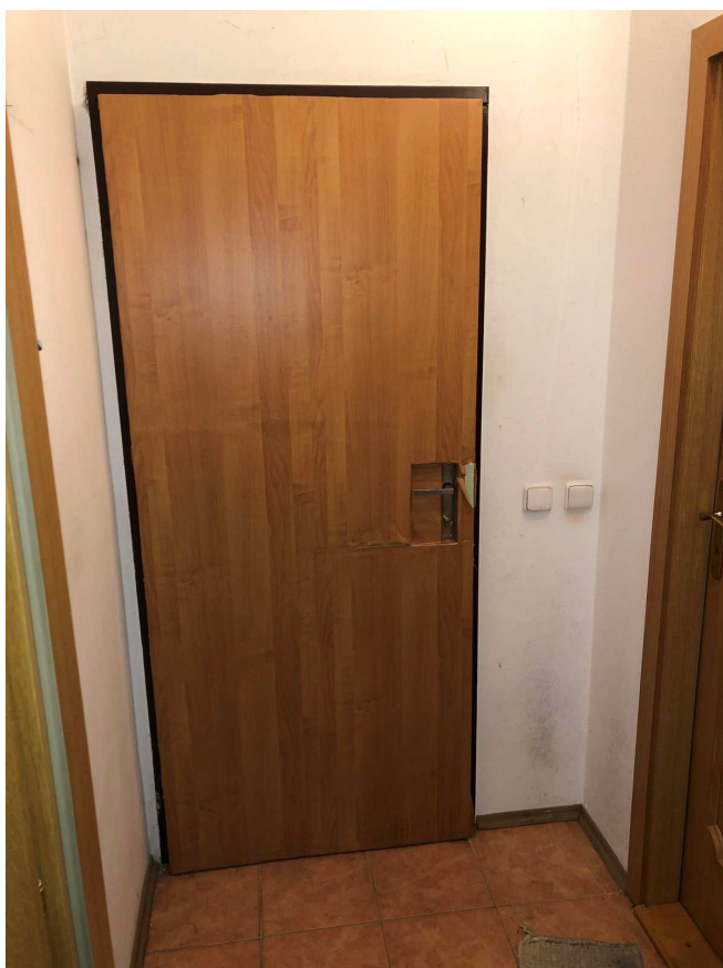
Obrázek 69: Provizorně zateplené dveře do garáže
