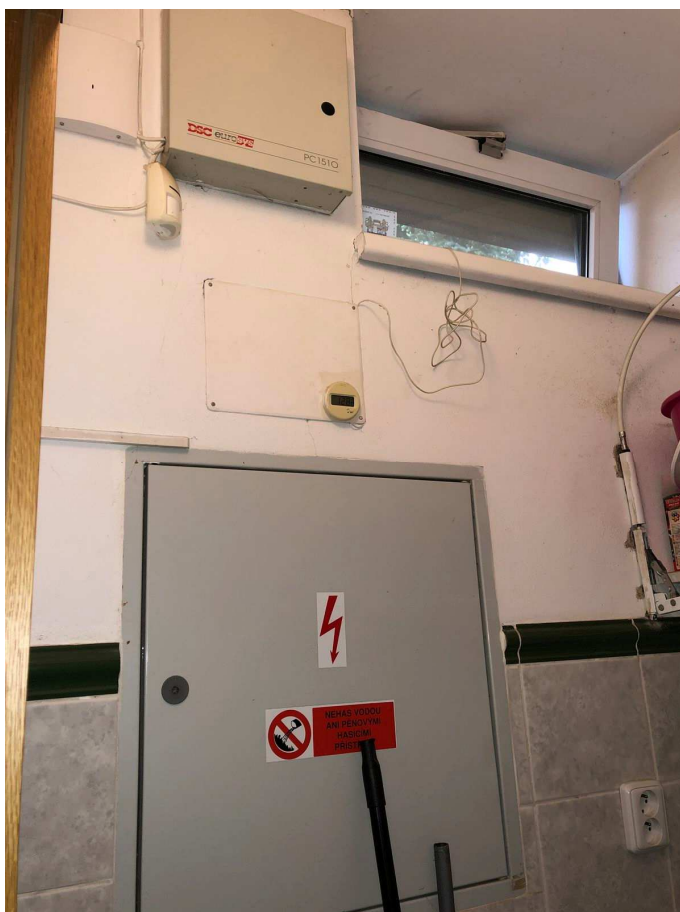
Obrázek 56: Tech. místnost - rozvaděč
