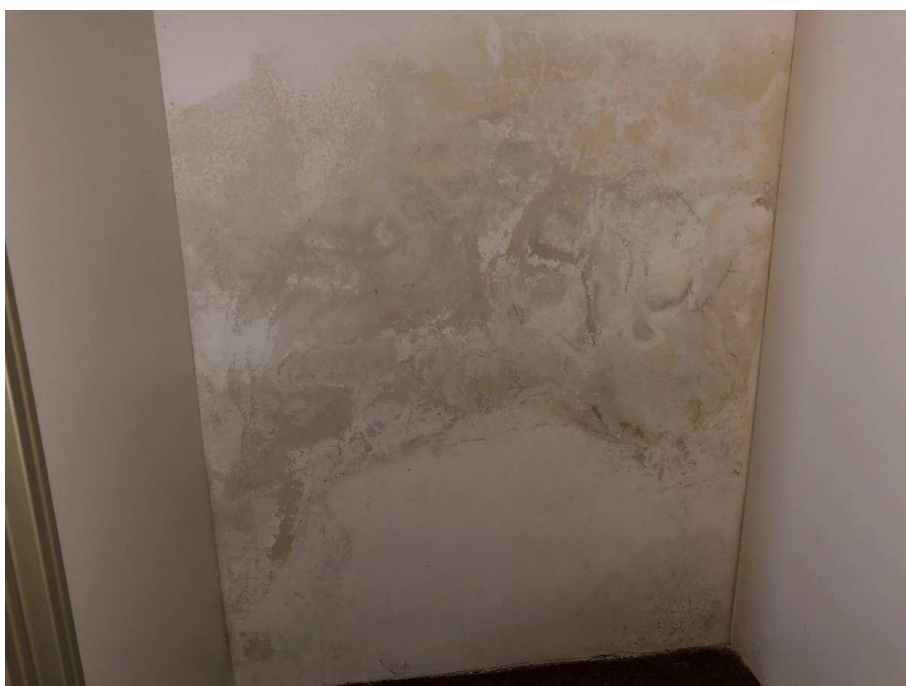
Obrázek 92: Výrazné projevy vlhkosti na stěně směrem k tech. místnosti / WC
