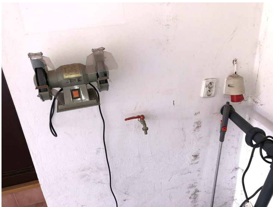
Obrázek 42: Vybavení garáže - bruska, vodní kohout a zásuvka 400 V
