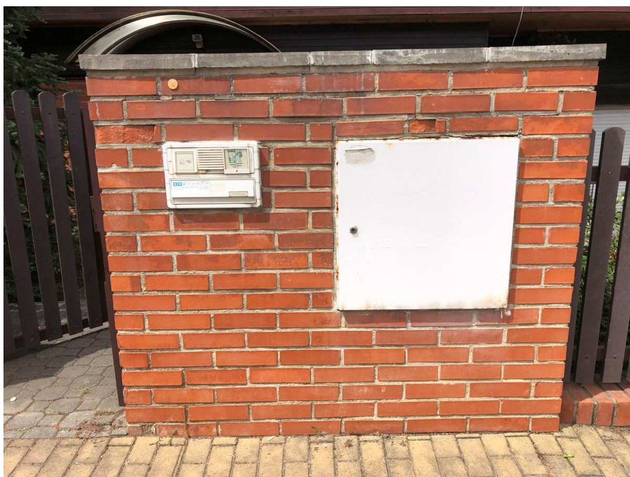
Obrázek 29: Sloupek u vstupu, patrné oprýskané cihly
