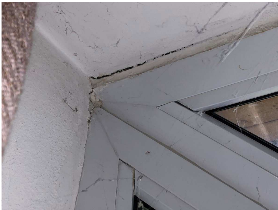
Obrázek 8: Vnitřní napojení okna, horní část - trhлина, netěsné
