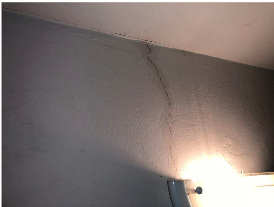
Obrázek 50: Trhlina ve stěně, pravděpodobně špatné zapravení drážky elektroinstalace
